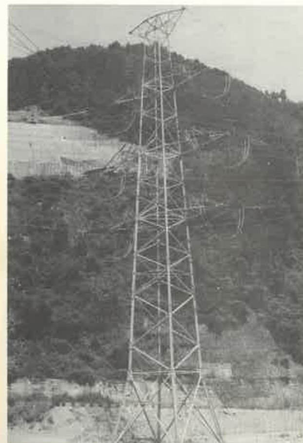
▲変換所連絡線引留鉄塔
