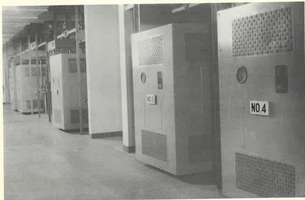
▲補機用乾式変圧器
