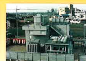
ガス絶縁開閉装置 Gas Insulated Switchgear
